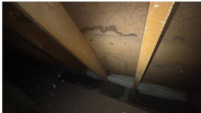
Bilden visar del av sidovind med fuktfläckar på träfiberskivor
