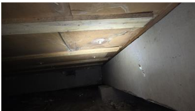
Bilden visar fuktfläckar på trossbottensskivor i grunden
